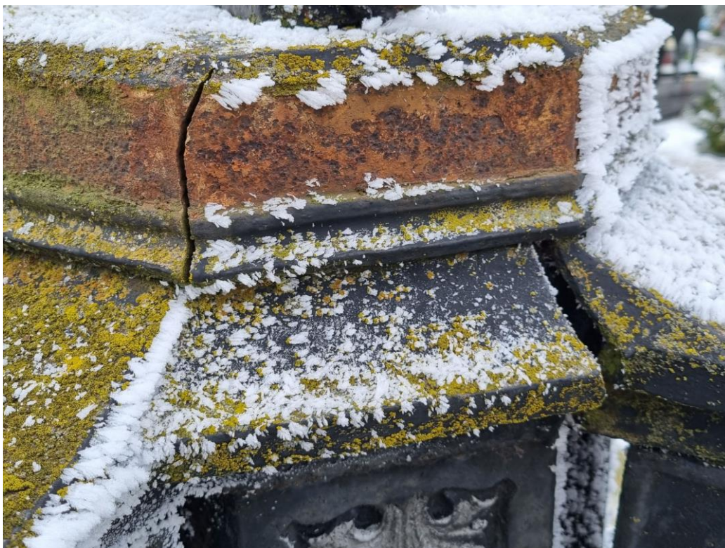
Detailní pohled na roztrženou římsu.
