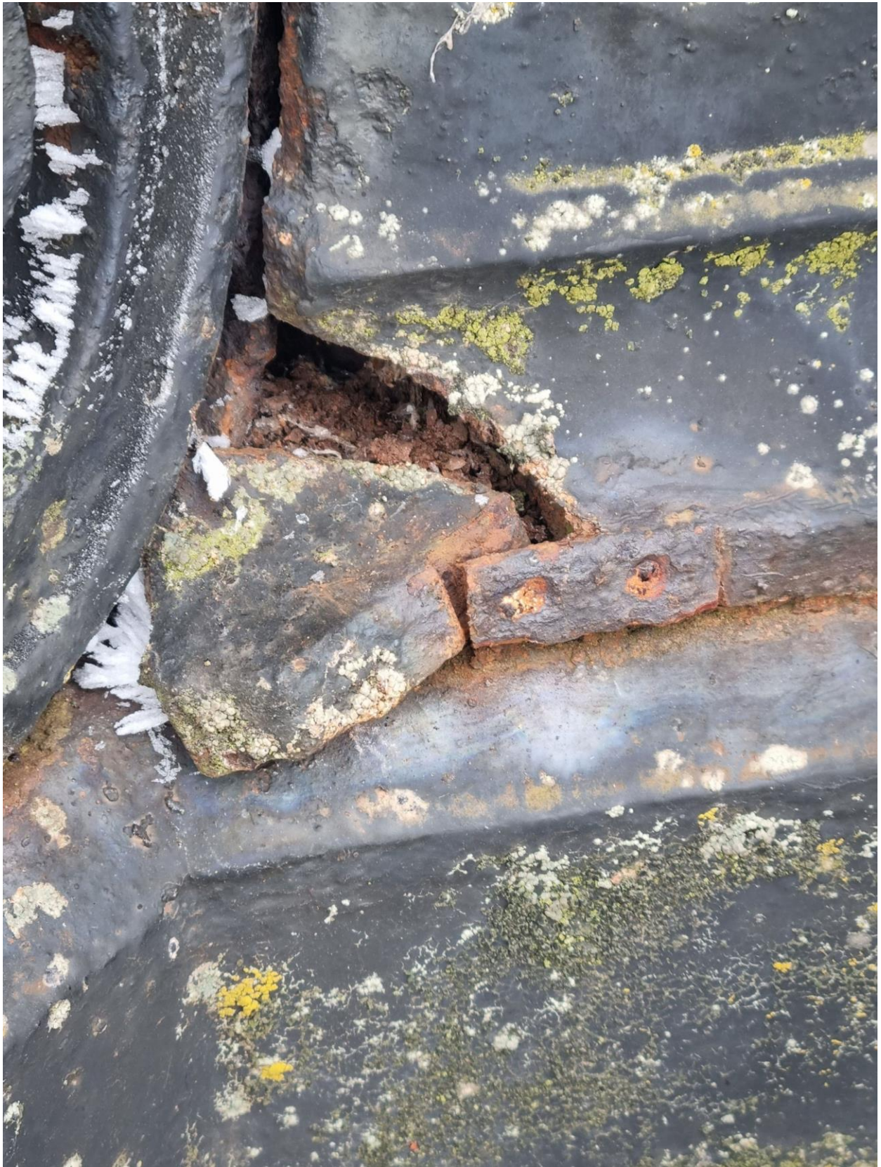
Detailní pohled na mechanické destrukce ve spodní části volutového podstavce.
